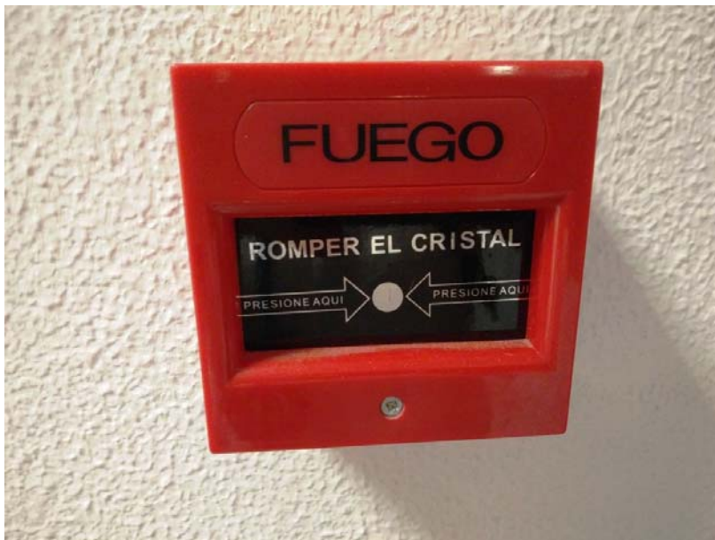
Foto 5: Pulsador de alarma de incendios.
