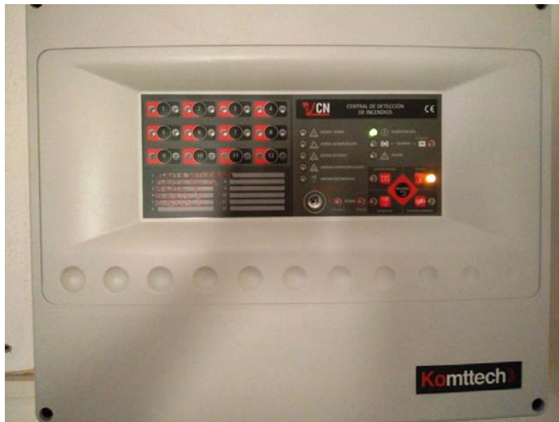
Foto 3: Centralita de alarma de incendios, general de todo el edificio, situada en planta baja.
