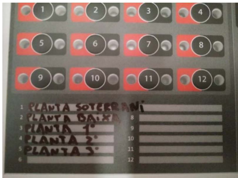
Foto 4: Central de detección y alarma de incendios, detalle de las zonas de todo el edificio.
